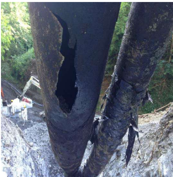
Rotture di tubazioni
