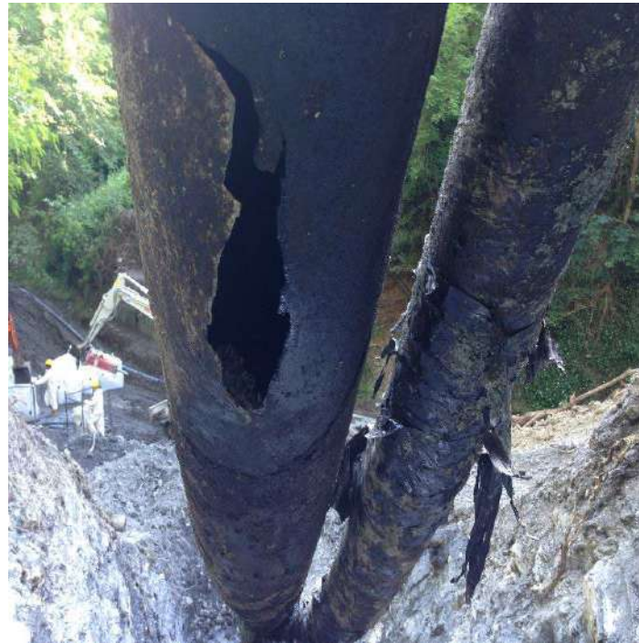
Rotture di tubazioni
